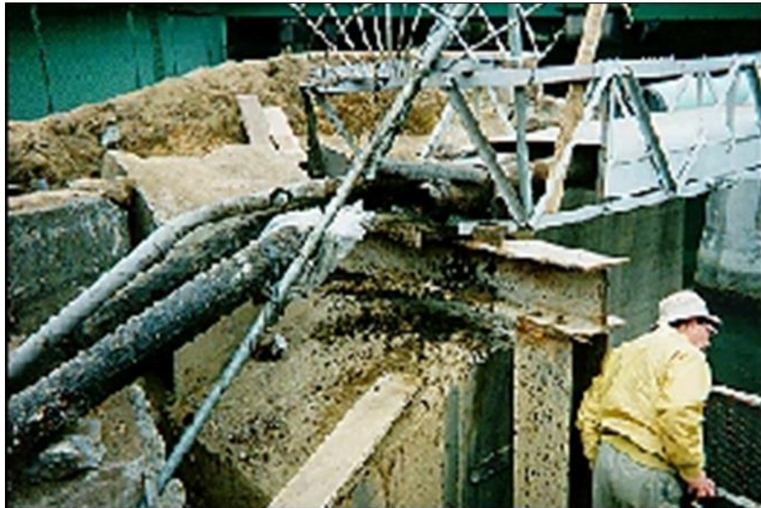
送電線の被害 (御影本町三丁目)
