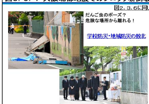
図3. 5. 4 大阪北部地震でのブロック塀倒壊
